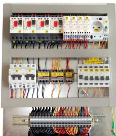
Widok na zamkniętą płytę automatyki
